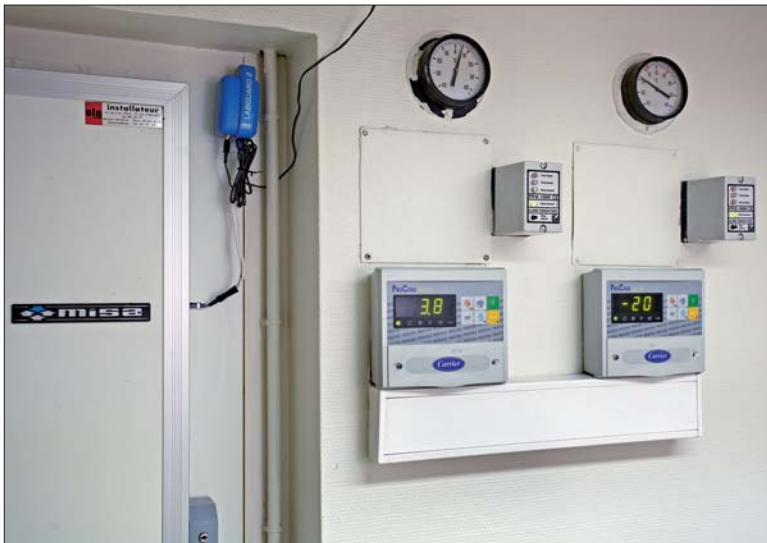
Figure 42. Affichage de la température à l'extérieur de la chambre climatisée.
